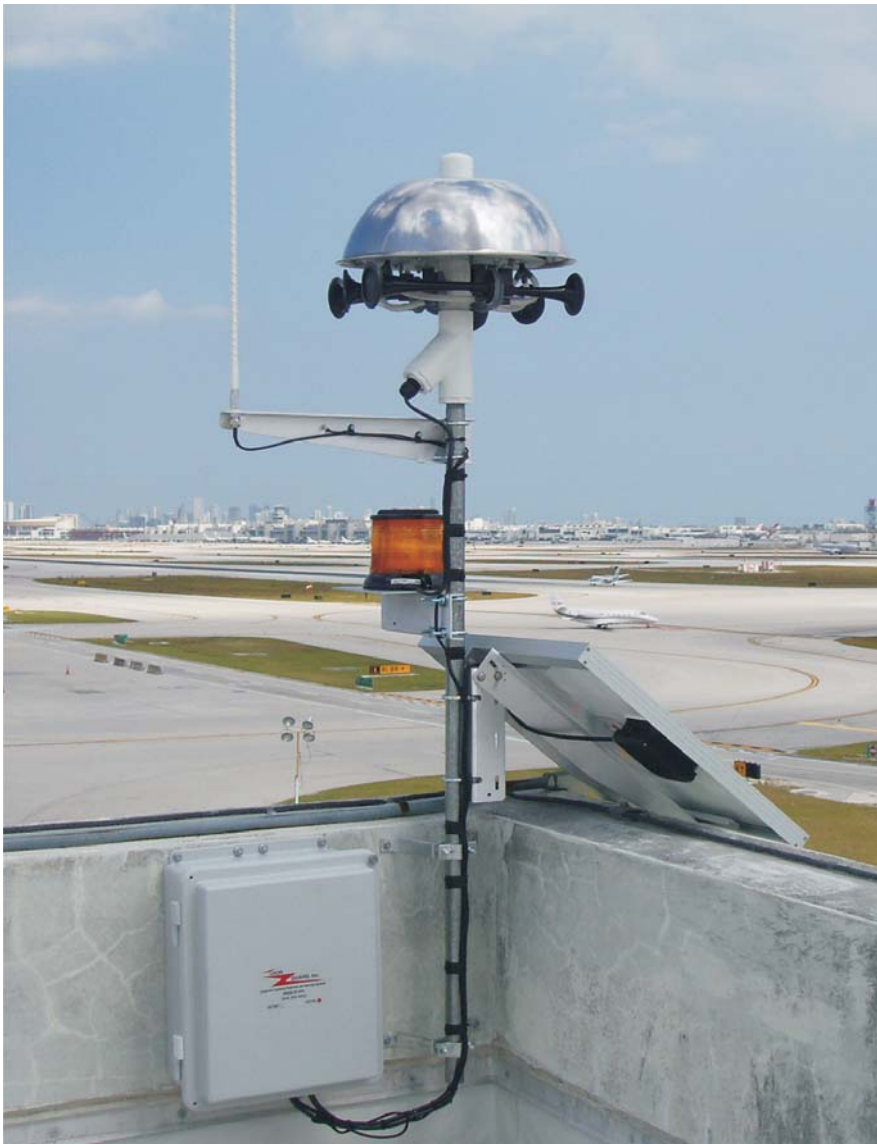
Rys. 4. Zdalna stacja syren
